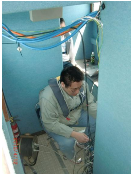
写真-3 キャビン内の様子
