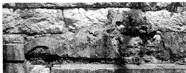
図8 北側壁面スタッコ跡
