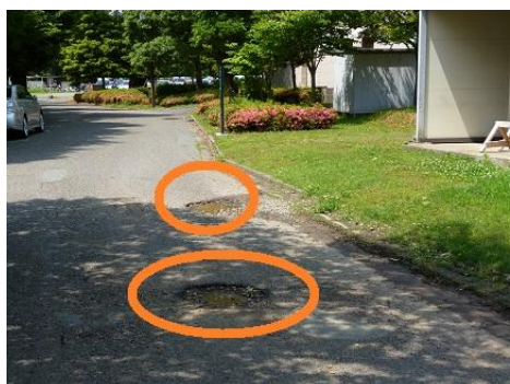
図1. 陥没した道路
