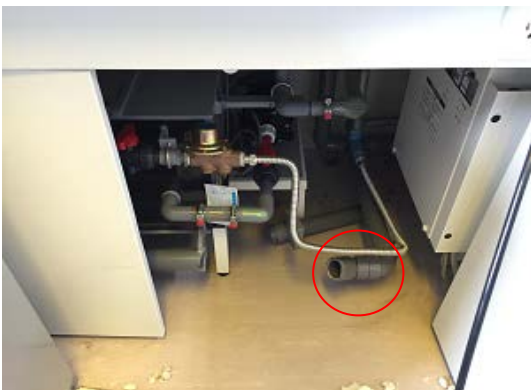
図 1 給水設備の断裂
