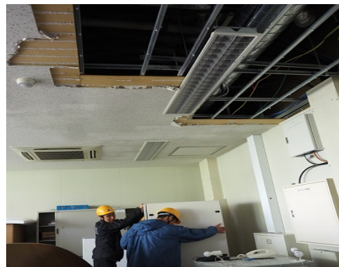
図 2 漏水での天井剥落
