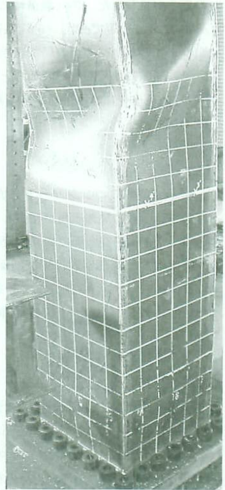
写真 2-1 LN-46 の崩壊状況 (南西柱部分)
