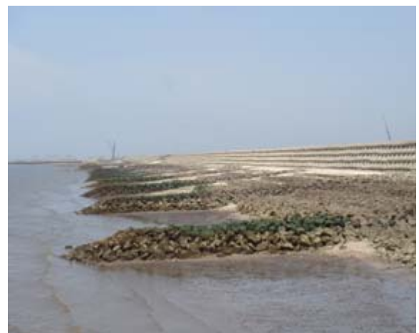
写真-3 既設の防護海岸に連続突堤と盛砂の施工による新たな海岸堤防の建設:消失した生物生息場が回復するとともに景観・親水機能も向上(熊本県玉名横島海岸)
