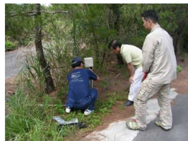
図 3 沖縄県国頭村安田での実地試験 (車両検出センサーの設置)
