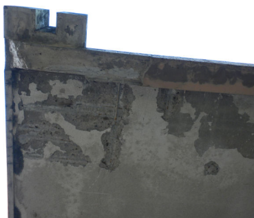
(写真2) 外壁の剥がれ
