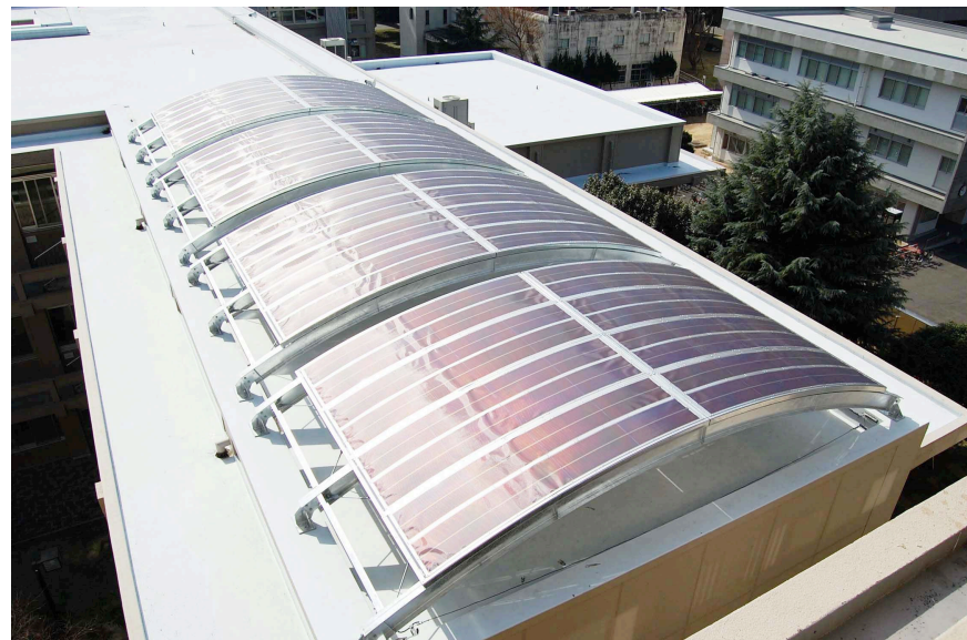
▲工学部2号館屋上に設置されたソーラーアーチ
