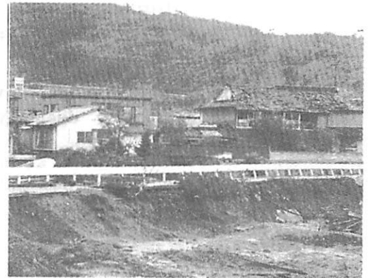
写真-2 和田船溜背後の越水による法面洗屈状況
