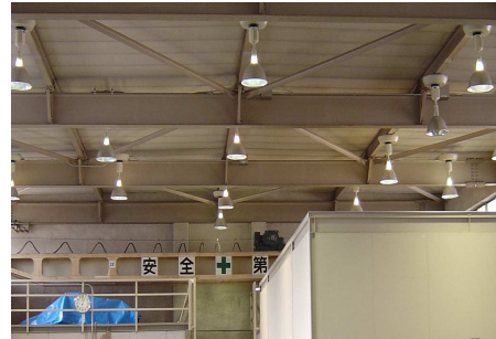
図 2.2 改修後の照明器具（水銀ランプ）
