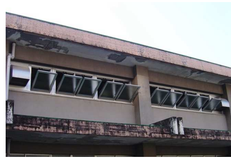
図 1.2 改修後の開閉窓と換気扇
