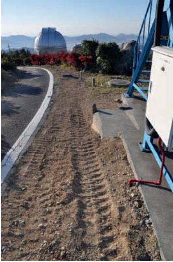
図 10 3 相 200V 供給元の隣接ドームと配電盤
