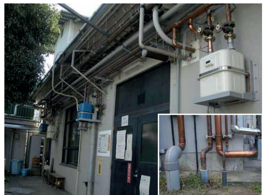
図3 センター側のガスメーター
