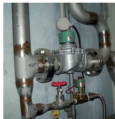
図 9 ガス放出切替用電磁弁
