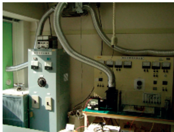
図8 常時排気システム
