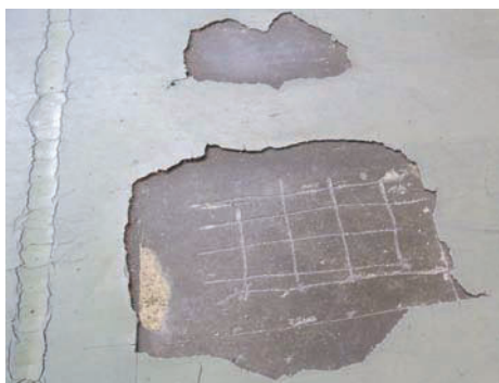
図6 ひび割れた床
