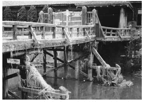
写真4 坪井教室(附属中学校)の被害の様子
