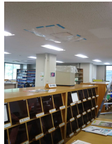
2016. 4. 18 (本震2日後) 薬学部分館2F天井(雨漏対応) 撮影
