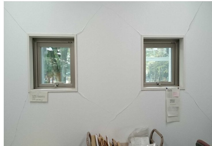
2016. 9. 15 撮影 中央館カウンター内壁 (ひび割れ)
