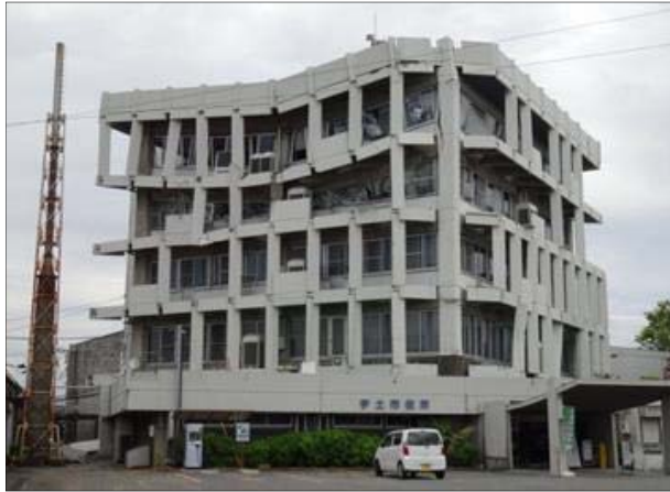
宇土市役所庁舎倒壊(宇土市)
