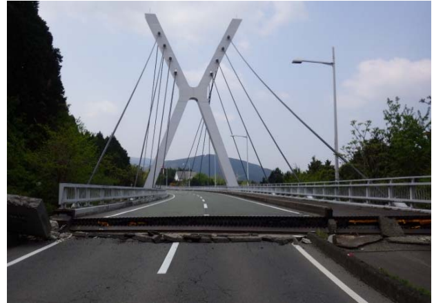
桑鶴橋被害(県道熊本高森線、西原村)
