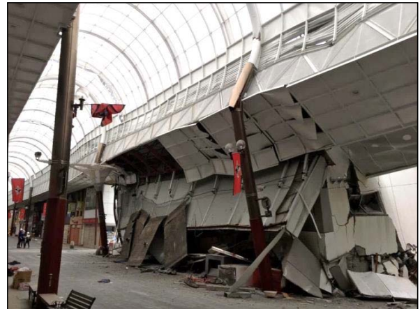
商店街アーケード崩壊(熊本市)
