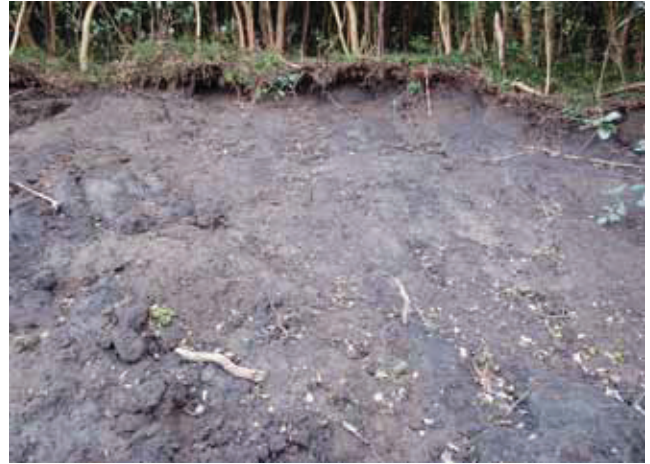
写真-5 伊豆大島における2013年10月16日崩壊の滑落崖とすべり面 (写真上部スケール基底付近のY1テフラ直下にすべり面が形成されている)
