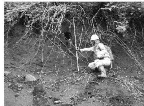
写真-11 表層崩壊源頭部のパイプ（古閑地区 1）
