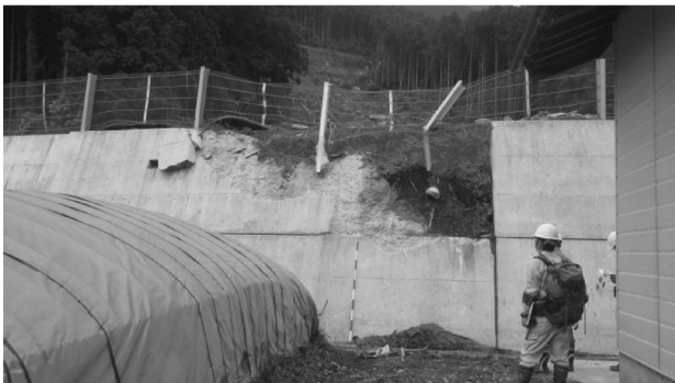
写真-16 被災した斜面下の擁壁
