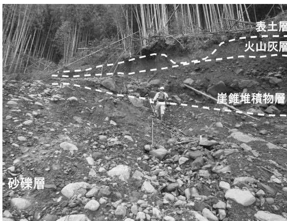
写真-5 滑落崖の状況
