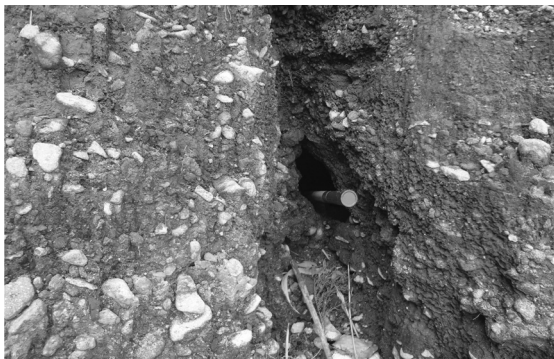
写真-2 三久保地区の崩壊 崩壊全景と砂礫層中に見られるパイピングホール （北緯 32°57′59.2″，東経 131°1′46.1″）
