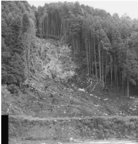
写真-9 急斜面の表層崩壊の例（中坂梨）
