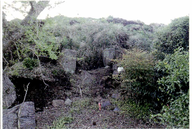
図 6 今城大塚古墳の石室入口をふさぐ崩落土
