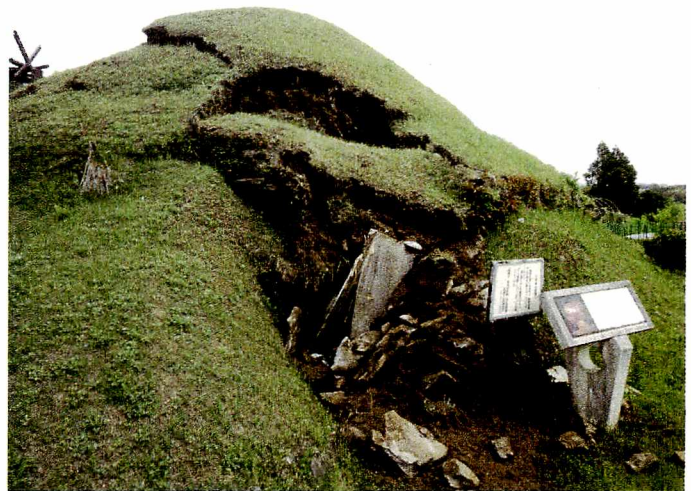
地震後の釜尾古墳（南西より）
