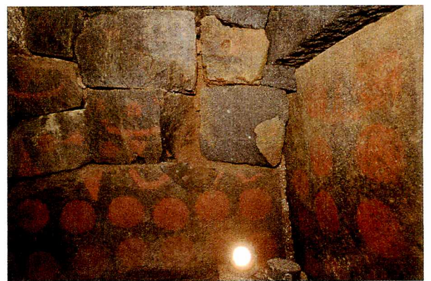
第 8 図 永安寺東古墳前室東側壁被災状況
