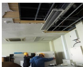
写真10. 漏水で抜けた天井
