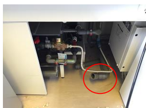
写真9. 給水設備の断裂
