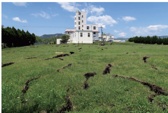
図 12 高野尾羽根火山頂部で北西-南西方向に発達した地割れ (南阿蘇村河陽). 写真奥の建物は京都大学火山研究センター.
