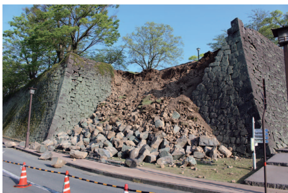
図 4 2016 年 4 月 14 日夜の熊本地震前震で倒壊した熊本城の石垣.
