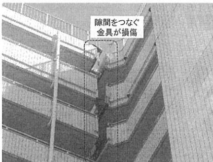
〔写真1〕 エキスパンションジョイント金具の損傷
