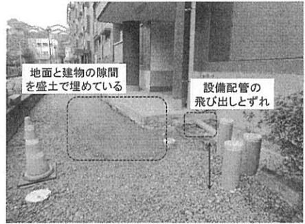
〔写真2〕 敷地が沈下し露出した設備配管
