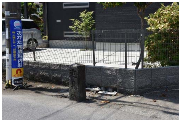
図5 沈下した電柱と道路脇の石碑(近見橋)
