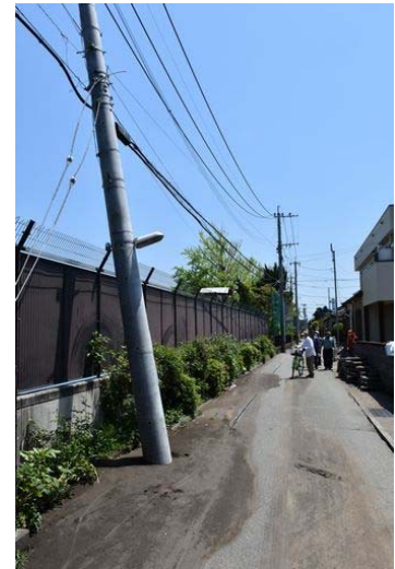
図1 噴砂と電柱の沈下・傾斜
