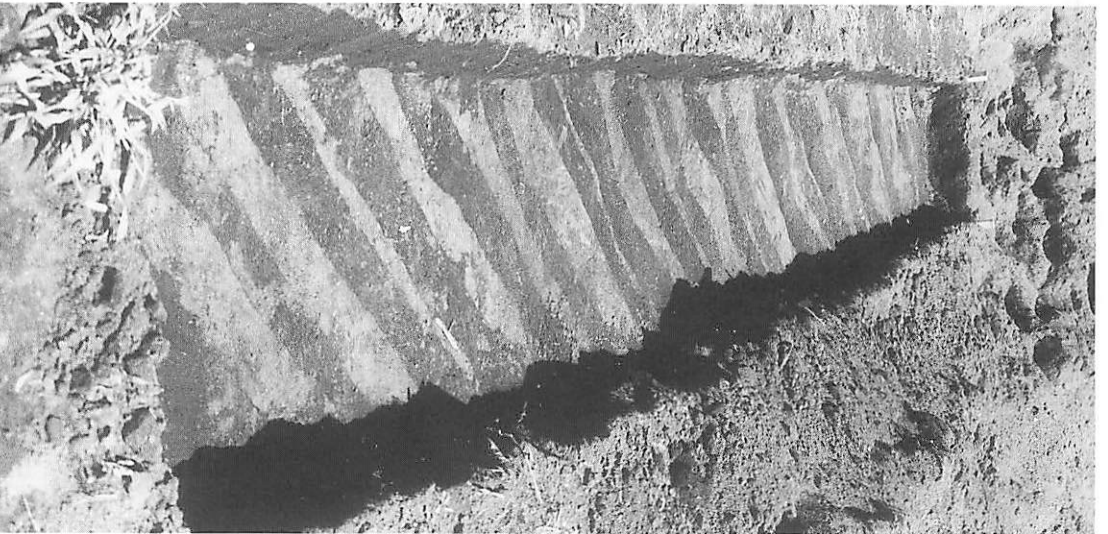
上 2号トレンチ 完掘状況 中 3号トレンチ 完掘状況 下 4号トレンチ 完掘状況
