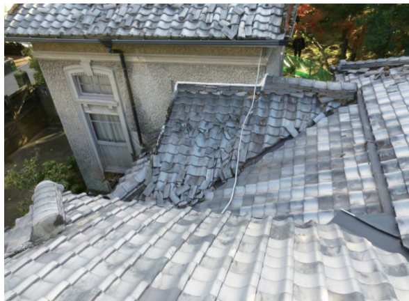
母屋と洋間接続部屋根損傷状況調査 撮影坂田
