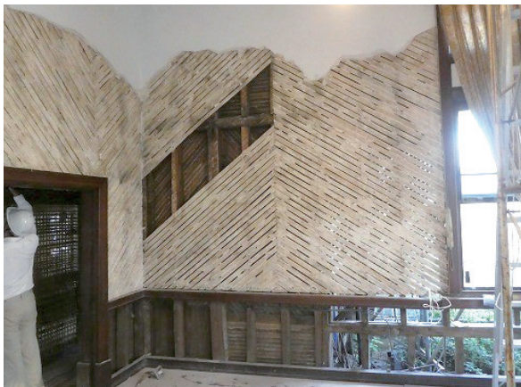
洋間漆喰壁剥落状況 撮影坂田
