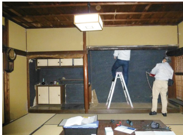
和室10帖床の間被災状況調査 撮影井田
